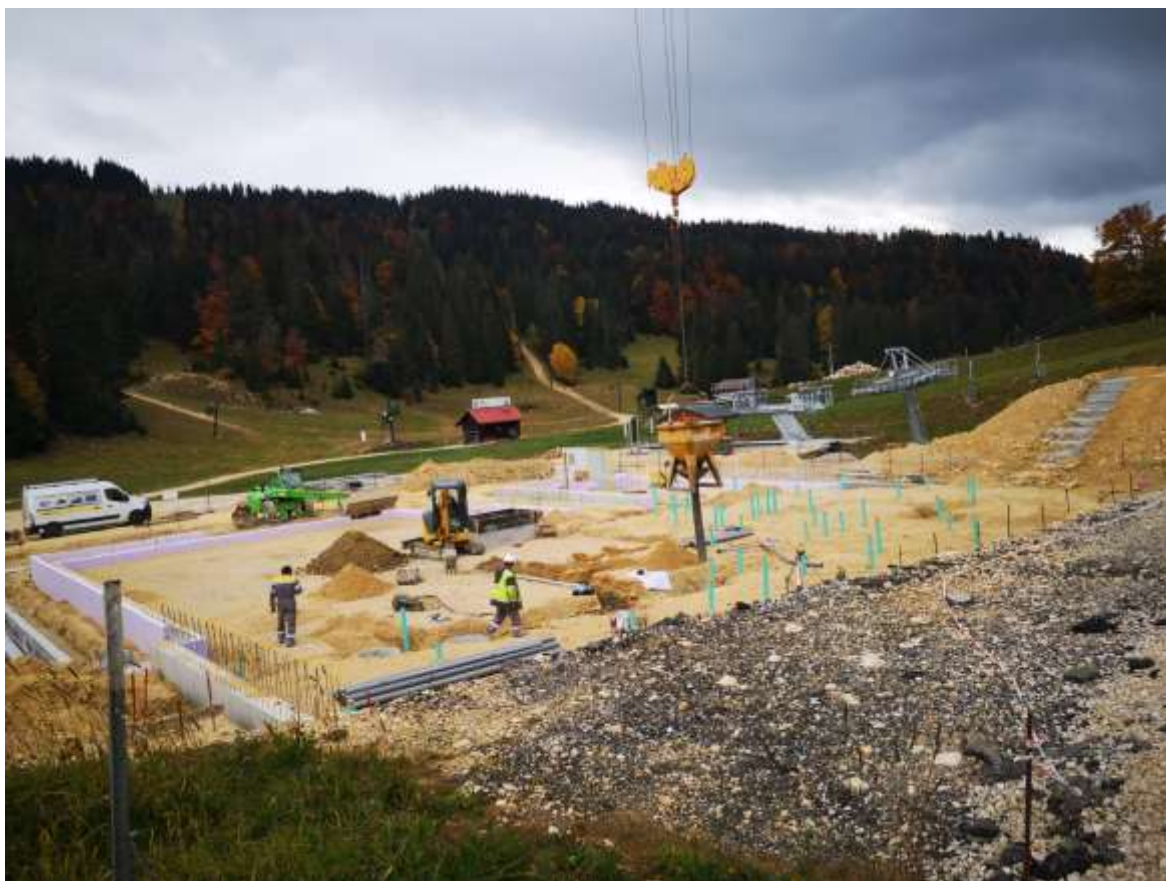
Figure 1. Travaux préparatoires pour la construction du radier du bâtiment d'accueil des Dappes
